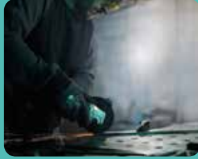
Luci da lavoro con raffreddamento insufficiente
